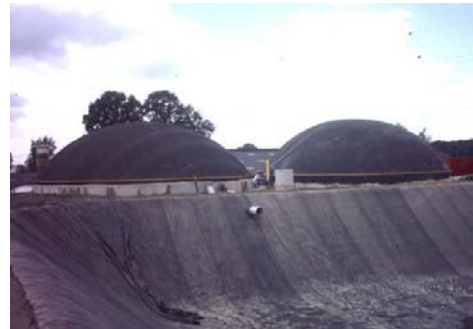
Digestor anaeróbico con laguna de desechos
